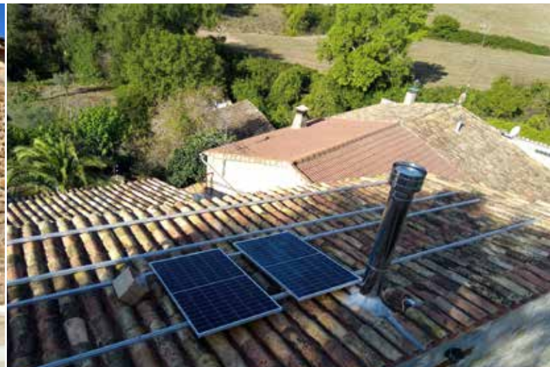
Instal·lació fotovoltaica Coop de Sol
